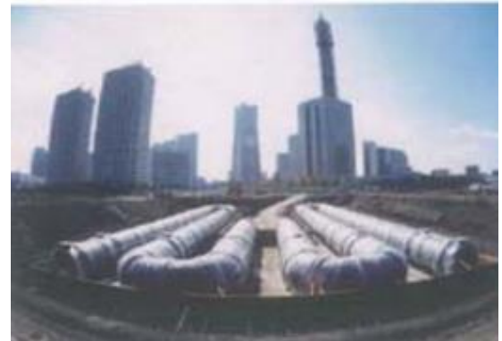
設置当時の災害用給水タンク (高島中央公園)
