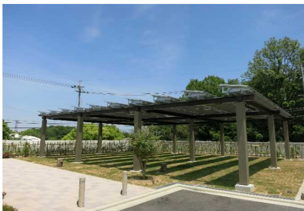
共有部へ設置した太陽光発電システム
